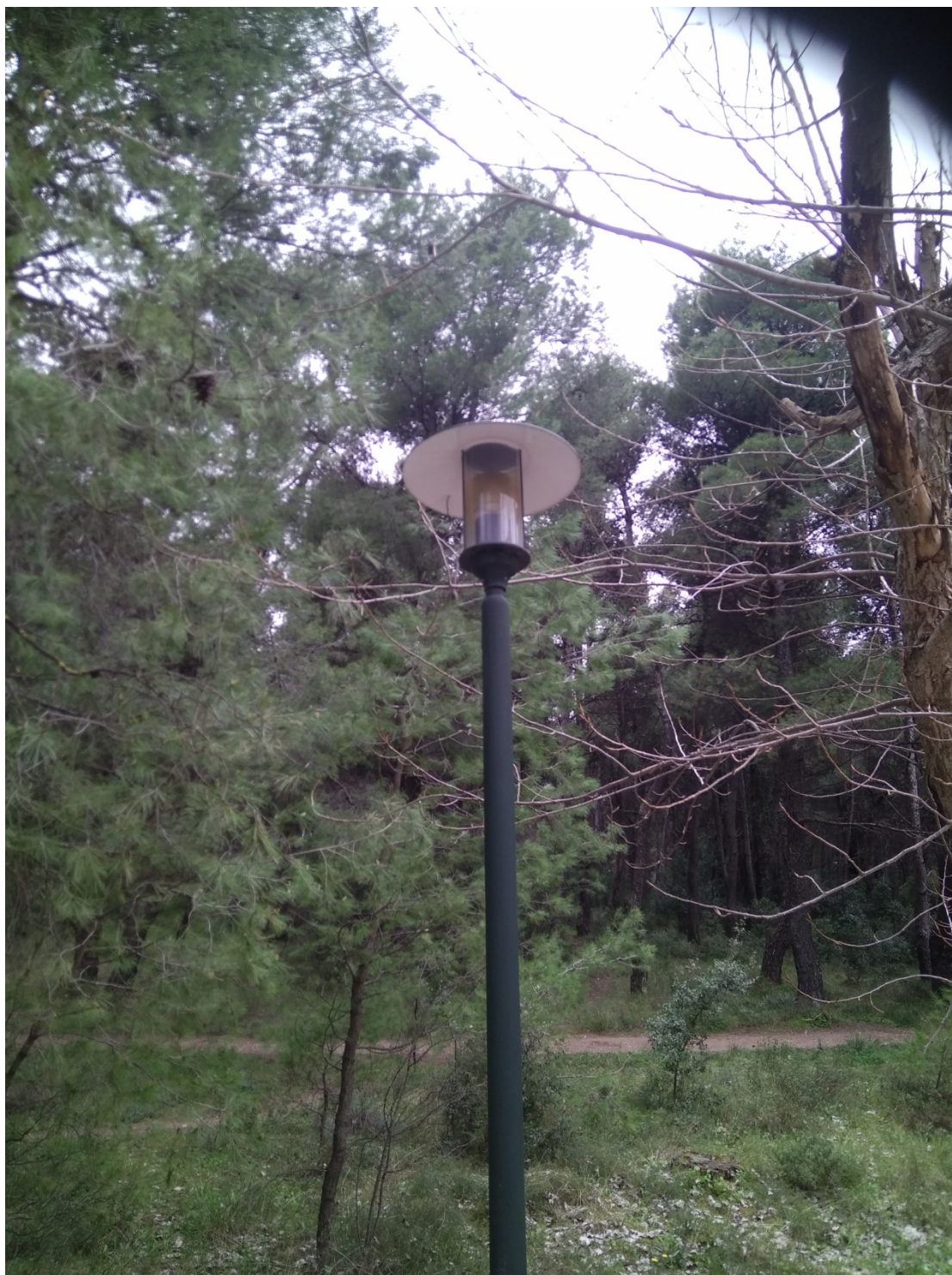
ΦΩΤΟΓΡΑΦΙΑ 14 (Είδη Τμήματος Δ, Άρθρο 18) ΦΩΤΙΣΤΙΚΟΥ ΣΩΜΑΤΟΣ ΚΕΦΑΛΗΣ ΑΛΟΥΜΙΝΙΟΥ ΜΕ ΑΤΣΑΛΙΝΟ ΚΑΠΕΛΟ ΓΙΑ ΛΑΜΠΤΗΡΑ ΤΥΠΟΥ E27 LED ΠΕΡΙΒΑΛΛΟΝ ΧΩΡΟΣ ΓΗΠΕΔΟΥ ΔΗΜΟΤΙΚΗΣ ΕΝΟΤΗΤΑΣ ΔΡΟΣΙΑΣ
