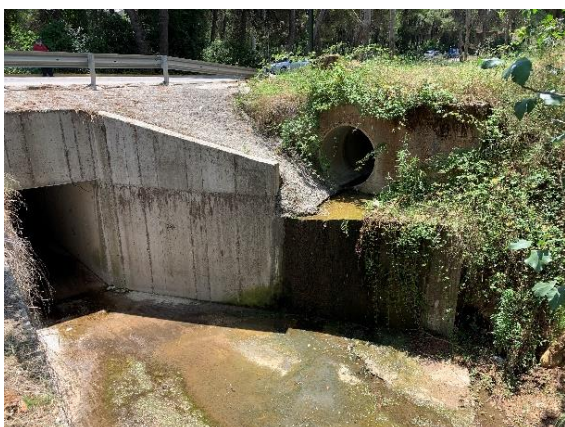
Εκβολή Τεχνικού (κατάτη οδού Θησέως)
