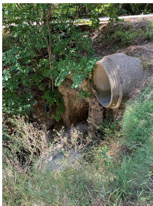
Τεχνικό ΤΧ4 και τοπικός Συλλεκτήρας Ομβρίων
