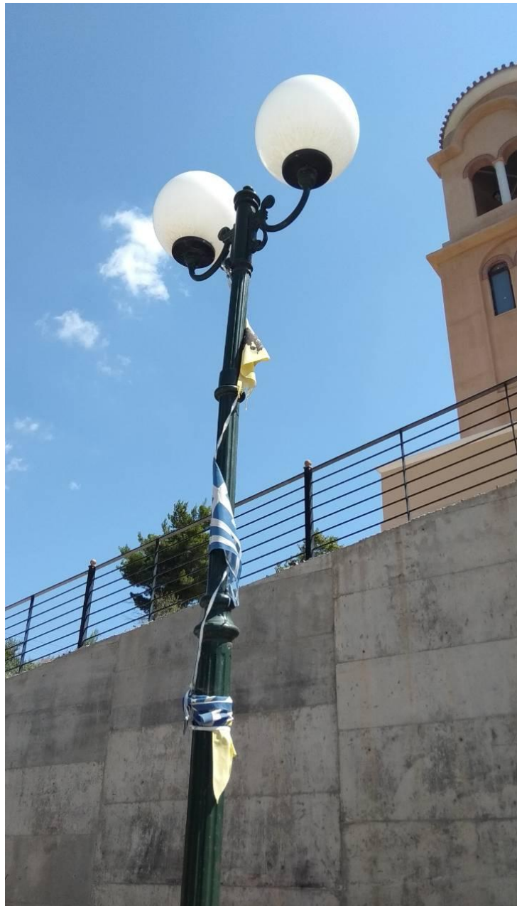
ΦΩΤΟΓΡΑΦΙΑ 15 (Είδη Υπομήματος Γ3, Άρθρο 9) ΚΕΦΑΛΗ ΜΕ ΒΑΣΗ ΣΤΗΡΙΞΗΣ, ΔΥΟ ΒΡΑΧΙΟΝΕΣ ΚΑΙ ΔΥΟ (2) ΦΩΤΙΣΤΙΚΑ ΣΩΜΑΤΑ Φ300 ΜΕ ΛΑΜΠΤΗΡΕΣ LED (ΟΔΟΣ ΜΕΓΑΛΟΥ ΑΛΕΞΑΝΔΡΟΥ ΔΗΜΟΤΙΚΗ ΕΝΟΤΗΤΑ ΣΤΑΜΑΤΑΣ)
