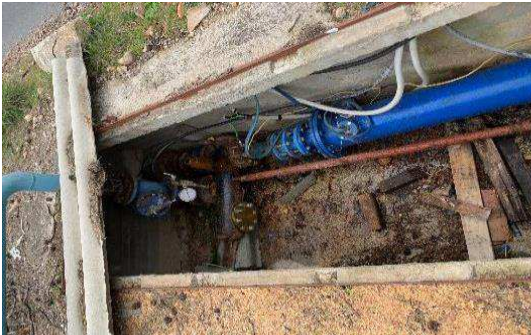
Φωτογραφία 2 : Άποψη του Α/Σ Ασκληπιού II
