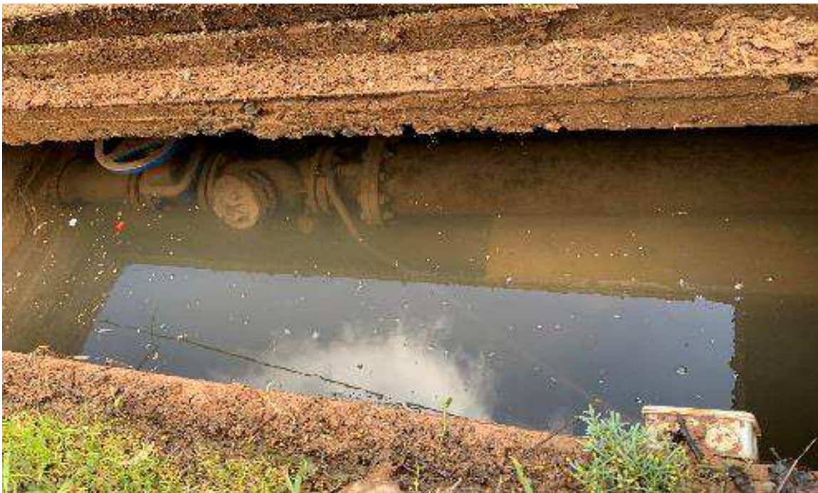
Φωτογραφία 6 : Άποψη του Α/Σ Σουλίου II
