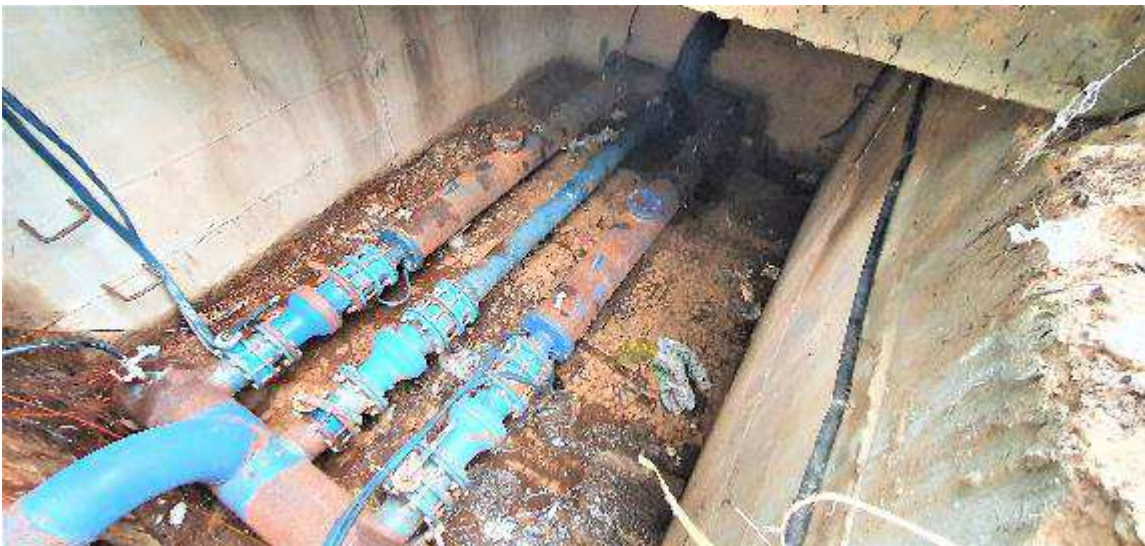
Φωτογραφία 1 : Άποψη του Α/Σ Ασκληπιού Ι
