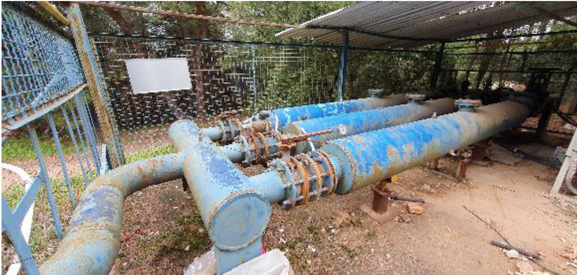
Φωτογραφία 7 : Άποψη του Α/Σ 3 Πεύκα Ι
