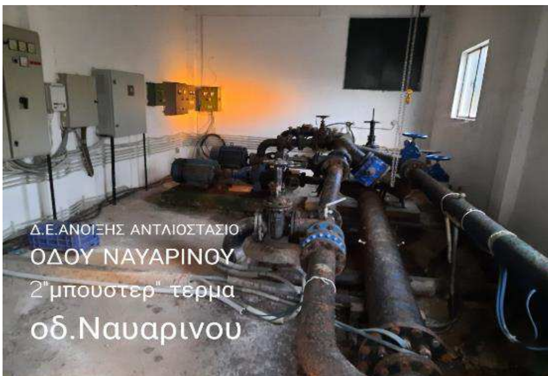
Φωτογραφία 4 : Άποψη του Α/Σ Ναυαρίνου
