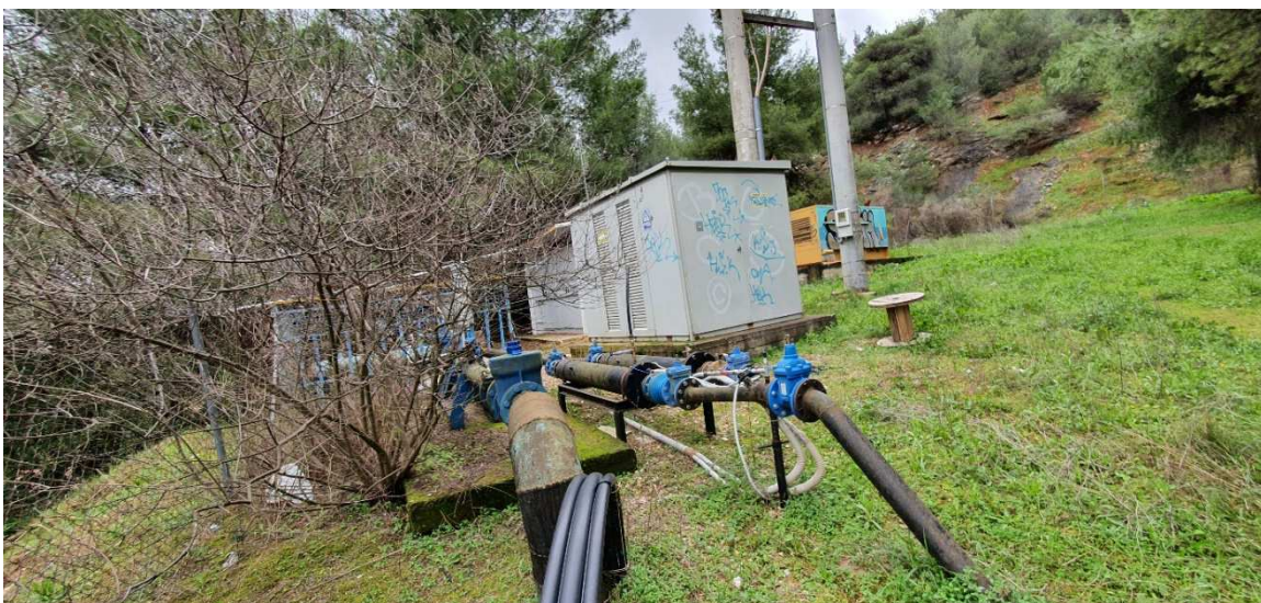
Φωτογραφία 8 : Άποψη του Α/Σ 3 Πεύκα ΙΙ
