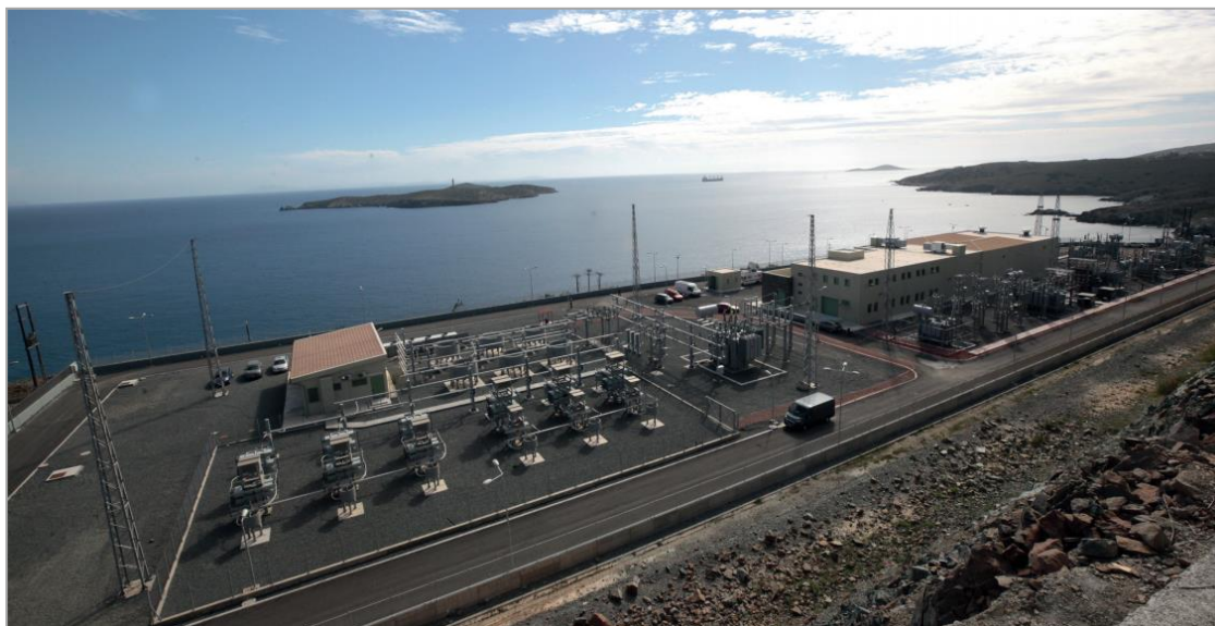
Εικόνα 7.2.4-1 Υποσταθμός (GIS) στην περιοχή Λαζαρέττα της Σύρου (Πηγή: ΑΔΜΗΕ,2018)
