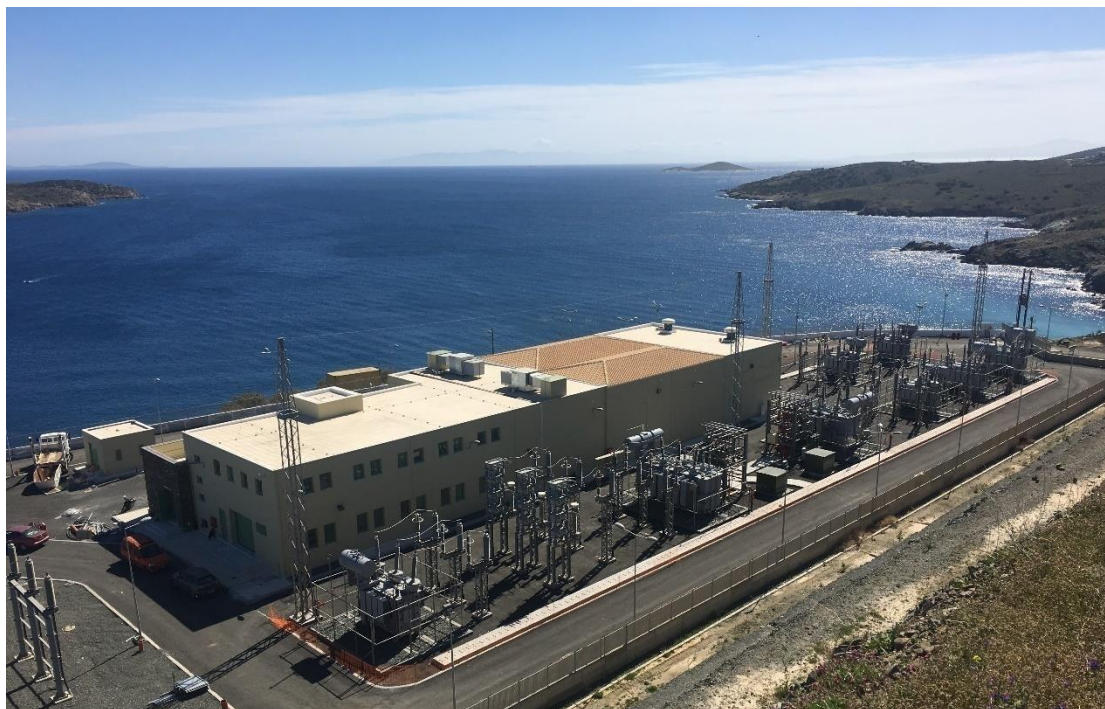
Υποσταθμός 150kV/Μέσης Τάσης Σύρου
