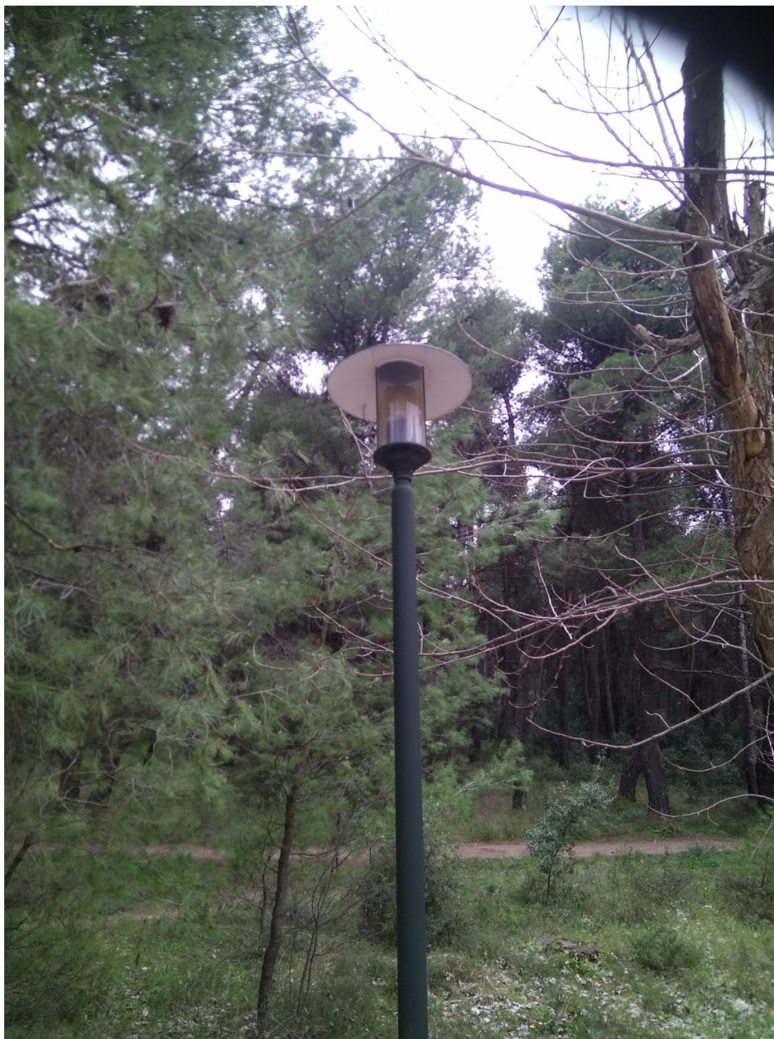
ΦΩΤΟΓΡΑΦΙΑ 13 (Είδη Υπομήματος Γ3, Άρθρο 13) ΦΩΤΙΣΤΙΚΟΥ ΣΩΜΑΤΟΣ ΚΕΦΑΛΗΣ ΑΛΟΥΜΙΝΙΟΥ ΜΕ ΑΤΣΑΛΙΝΟ ΚΑΠΕΛΟ ΓΙΑ ΛΑΜΠΤΗΡΑ ΤΥΠΟΥ E27 LED ΠΕΡΙΒΑΛΛΟΝ ΧΩΡΟΣ ΓΗΠΕΔΟΥ ΔΗΜΟΤΙΚΗΣ ΕΝΟΤΗΤΑΣ ΔΡΟΣΙΑΣ
