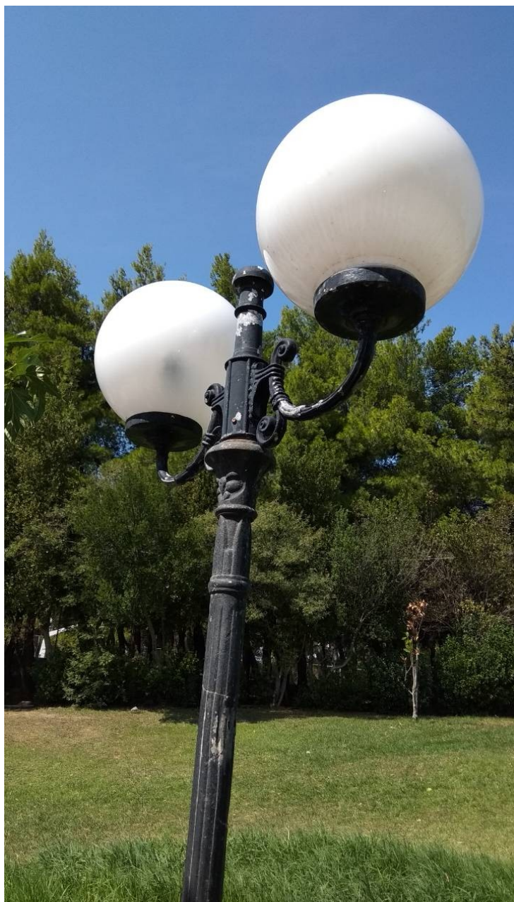
ΦΩΤΟΓΡΑΦΙΑ 2 (Είδη Υποστήριξης Γ3, Άρθρο 9) ΚΕΦΑΛΗ ΜΕ ΒΑΣΗ ΣΤΗΡΙΞΗΣ, ΔΥΟ ΒΡΑΧΙΟΝΕΣ ΚΑΙ ΔΥΟ ΦΩΤΙΣΤΙΚΑ ΜΠΑΛΑΣ Φ300MM ΜΕ ΛΑΜΠΤΗΡΕΣ LED (ΠΛΑΤΕΙΑ Ν. ΠΛΑΣΤΗΡΑ ΔΗΜΟΤΙΚΗ ΕΝΟΤΗΤΑ ΚΡΥΟΝΕΡΙΟΥ)
